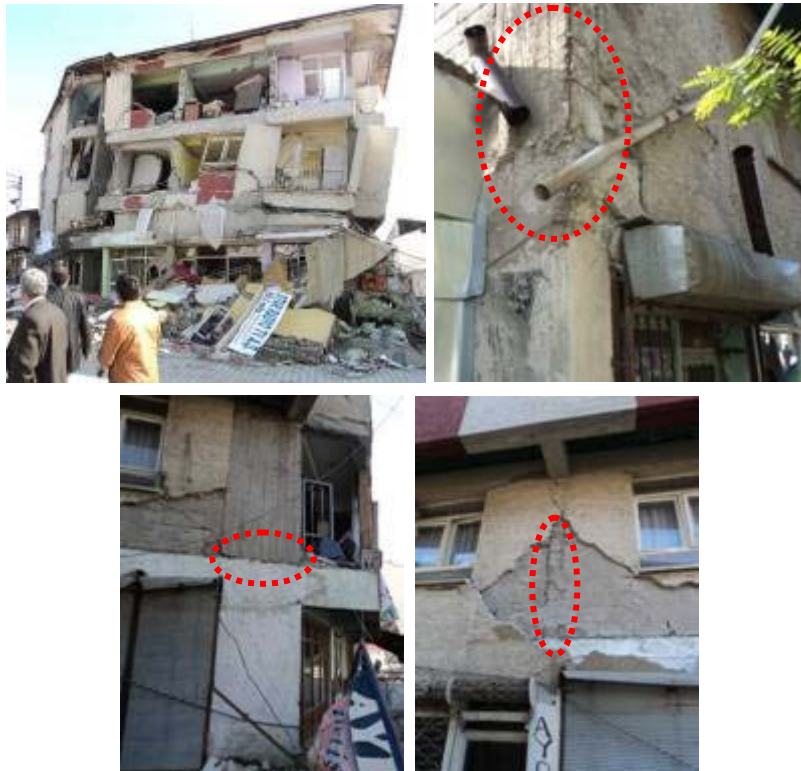
Şekil 4.7 – Betonun yerleştirilmesi ile ilgili sorunlar
