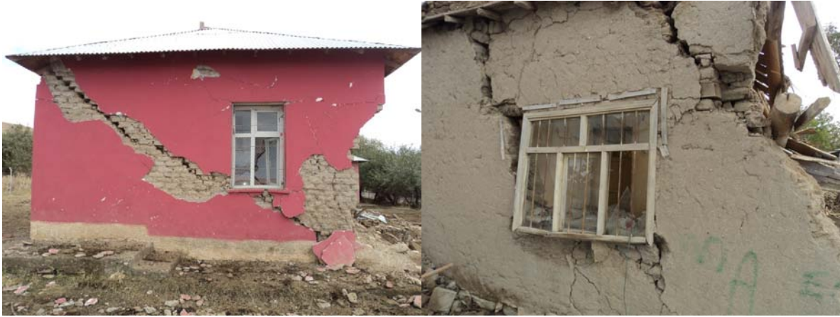
Şekil 4.36 – Bölgedeki yığma yapılarda oluşan çapraz çatlaklar ve yıkılmalar
