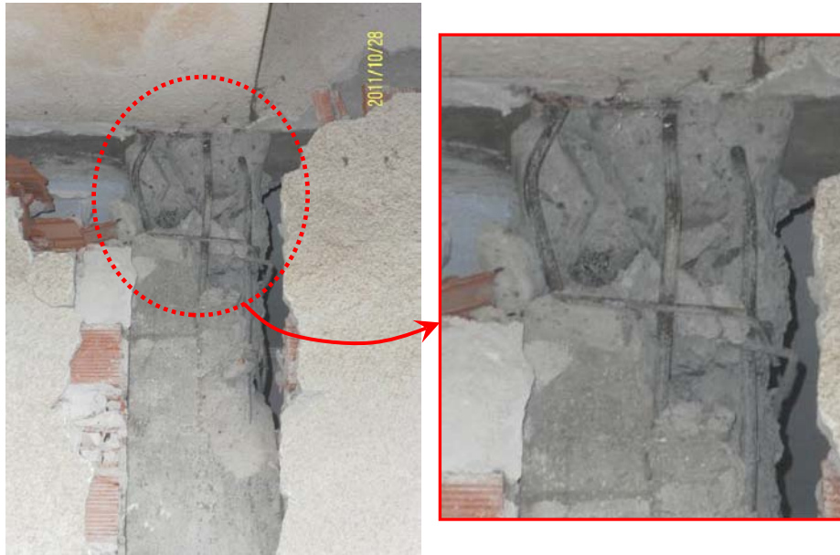
Şekil 4.15 – Kolon üst ucundaki etriye kancalarında yeterli ankraj bulunmaması
