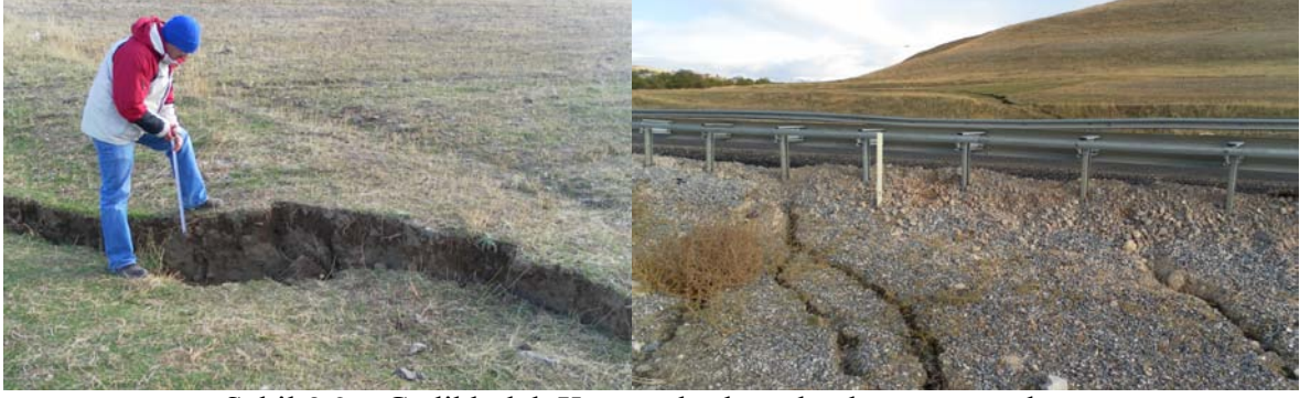
Şekil 3.2 – Gedikbulak Köyü yakınlarında oluşan yer çatlağı
