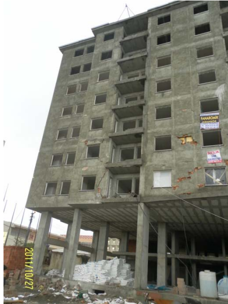
Şekil 4.24 – Tuğla duvarların devam ettirilmemesi ve asma kat bulunması nedeniyle ortaya çıkan “yumuşak kat” riski
