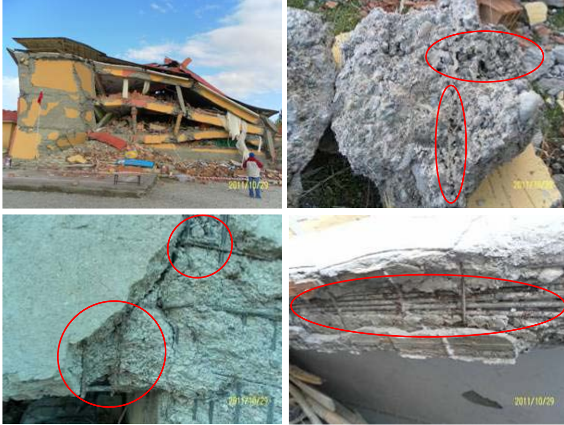
Şekil 4.8 – Gedikbulak İlköğretim Okulu binasında betonun yerleştirilmesi ve sıkıştırılması ile ilgili sorunlar
