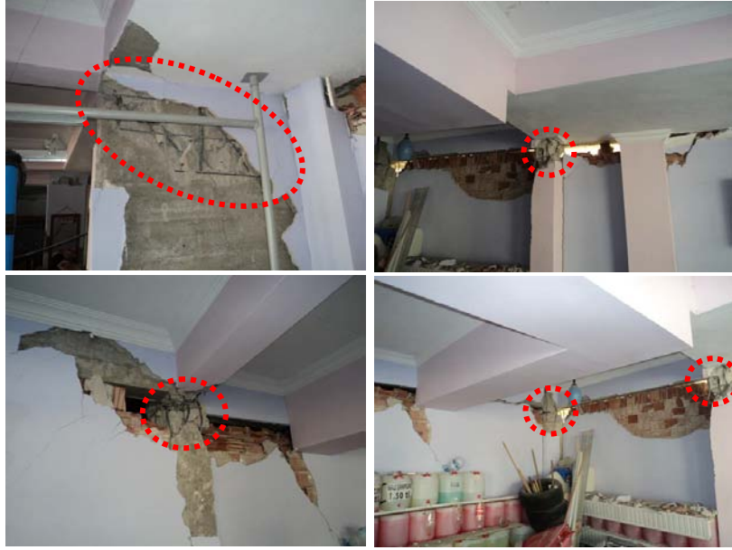
Şekil 4.20 – Yetersiz sargı donatısı nedeniyle zemin kat kolonlarında hasar oluşması
