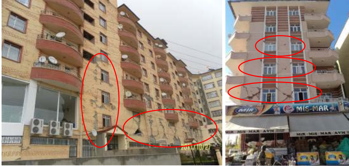
Şekil 4.2 – Van-merkez ve Erciş’te gözlenen tipik duvar çatlakları
