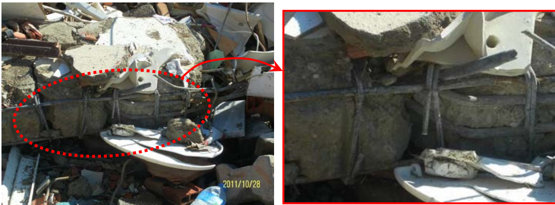
Şekil 4.13 – Kiriş içerisindeki etriye kancalarında yeterli ankraj bulunmaması
