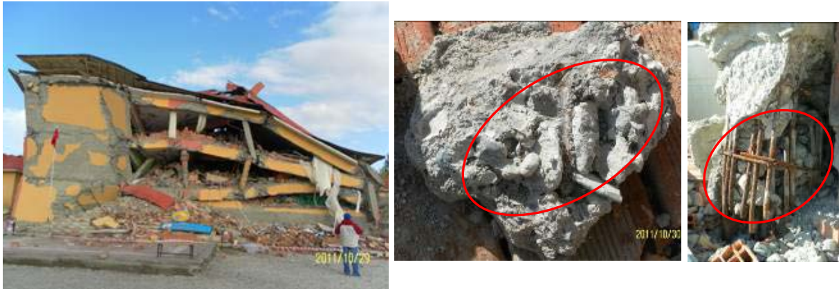
Şekil 4.4 – Gedikbulak İlköğretim Okulu binasında agrega ile ilgili sorunlar
