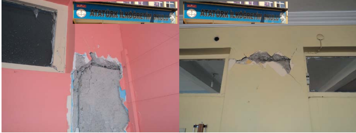
Şekil 4.48 – Erciş Atatürk İlköğretim Okulu'nun kolon ve perde duvarlardaki hasarlar
