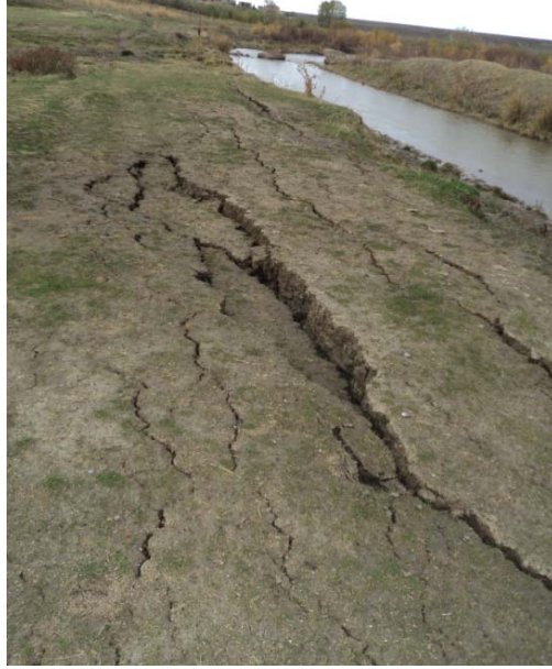
Şekil 3.3 – Tevekli Köyü yakınlarında oluşan yer çatlağı
