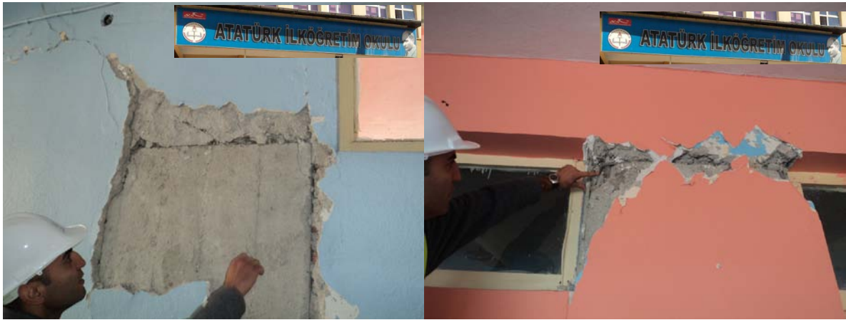
Şekil 4.47 – Erciş Atatürk İlköğretim Okulu'nun kolon ve perde duvarlardaki hasarlar
