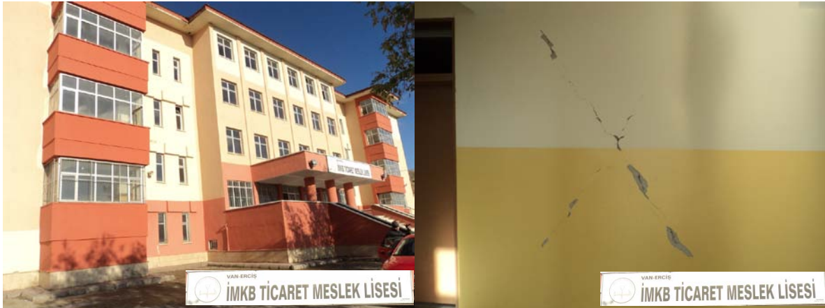
Şekil 4.51 – Erciş İMKB Ticaret Meslek Lisesi'nin genel görünümü ve bazı duvarlarındaki çatlaklar
