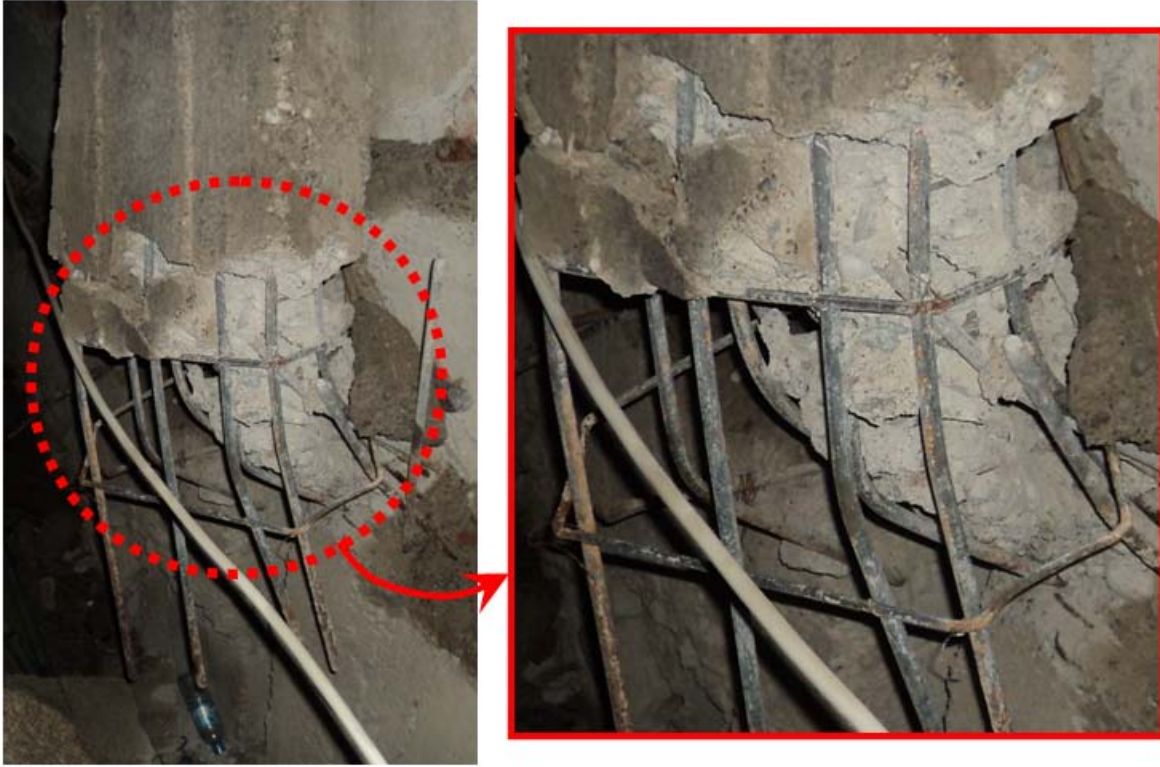
Şekil 4.14 – Kolon alt ucundaki etriye kancalarında yeterli ankraj bulunmaması
