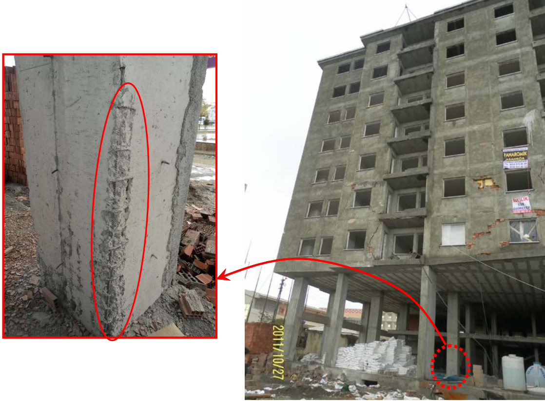
Şekil 4.6 – Kolon alt ucunda iyi yerleştirilememiş beton
