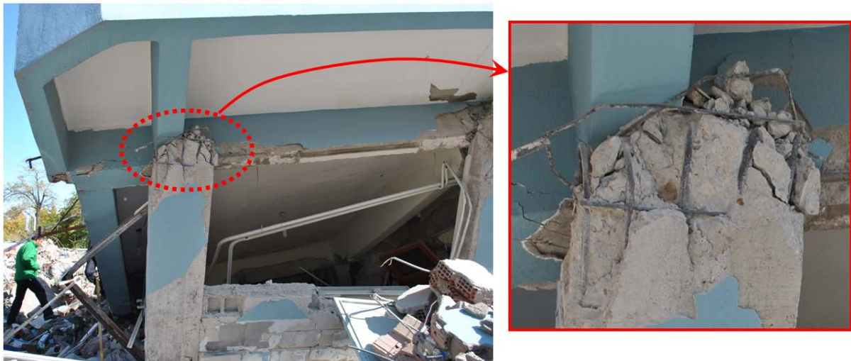
Şekil 4.17 – Kolon üst ucunda etriye sıklaştırması yapılmaması
