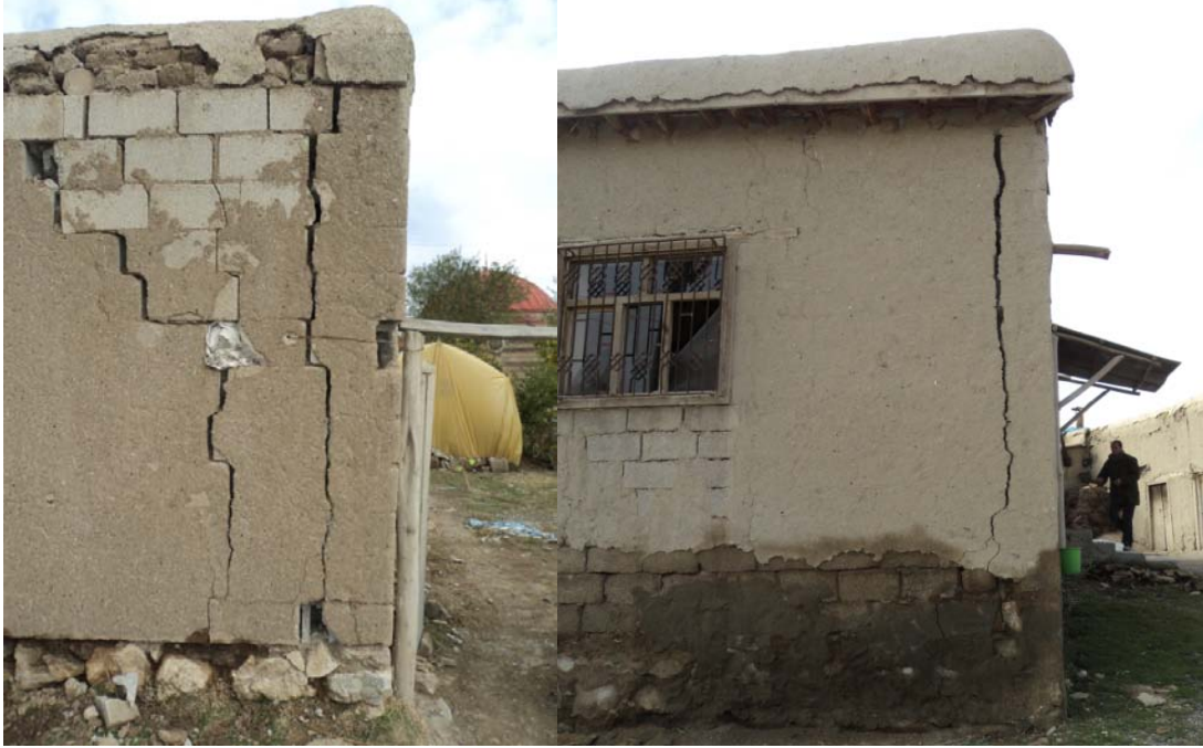
Şekil 4.30 – Bölgedeki yığma yapıların köşelerinde oluşan düşey çatlaklar ve ayrılmalar
