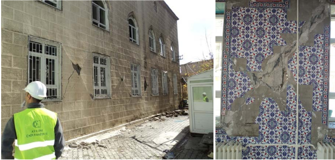
Şekil 4.83 – Erciş Camisi'nin duvarlarındaki çapraz çatlaklar
