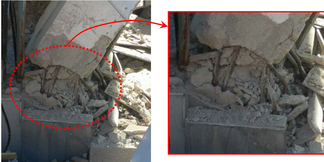
Şekil 4.16 – Kolon alt ucunda etriye sıklaştırması yapılmaması
