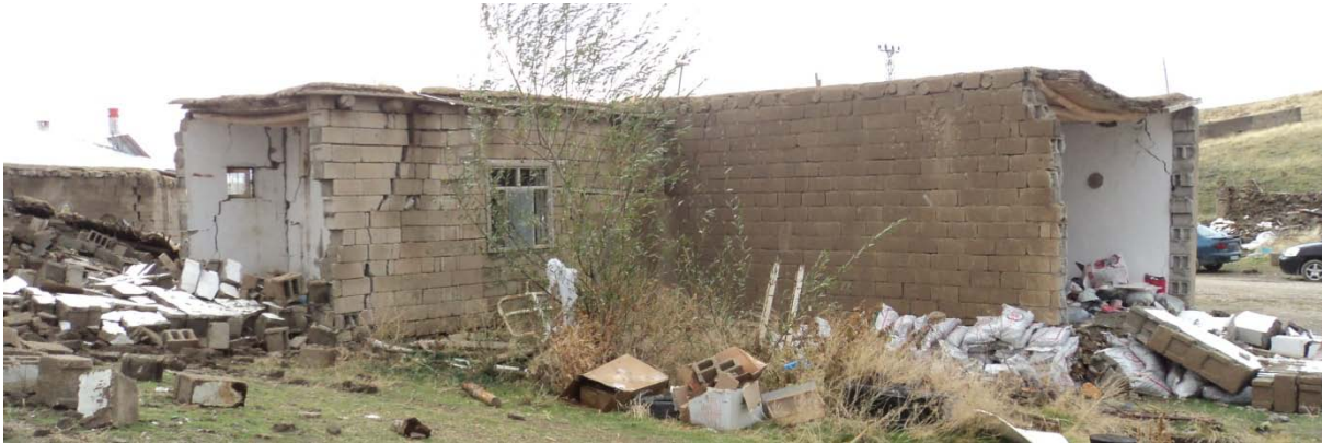
Şekil 4.31 – Köşelerde oluşan düşey çatlaklar ve ayrılmalardan kaynaklanan duvar yıkılmaları
