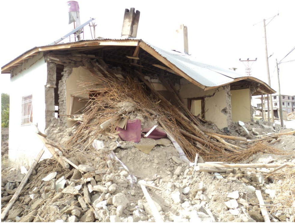
Şekil 4.39 – Tipik çatı ile yan duvarların ayrılması sonucu oluşan yıkılmalar
