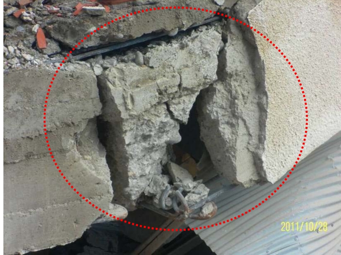
Şekil 4.12 – Birleşim bölgesinde yetersiz donatı kenetlenmesi
