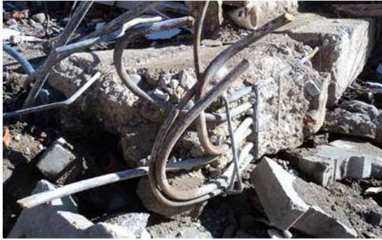
Şekil 4.10 – Nervürsüz donatı çubuklarının beton içerisinden sıyrılması
