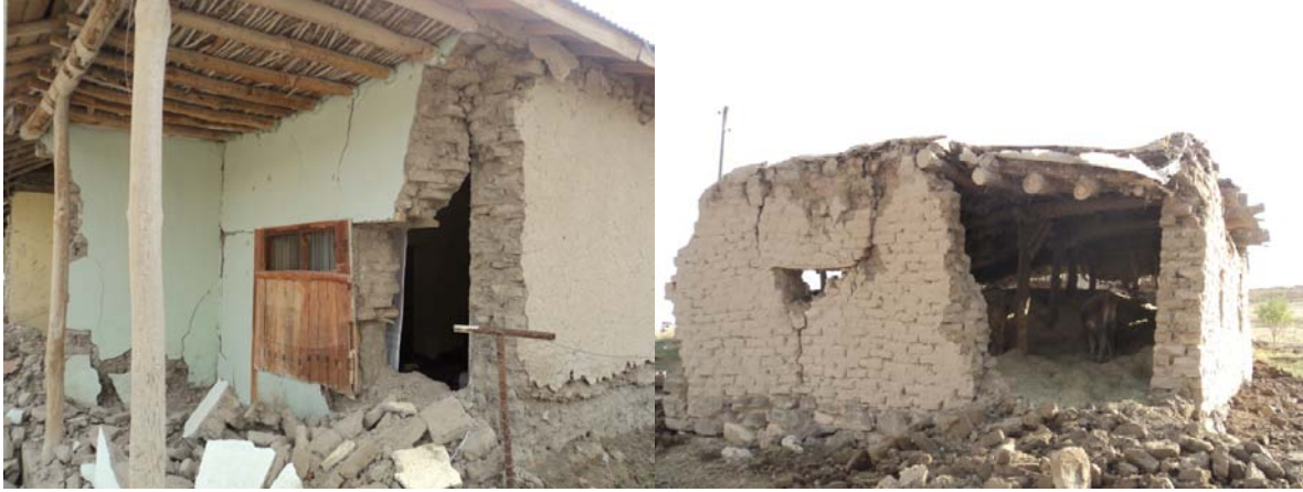
Şekil 4.32 – Düşey çatlaklar nedeniyle oluşan köşe yıkılmaları
