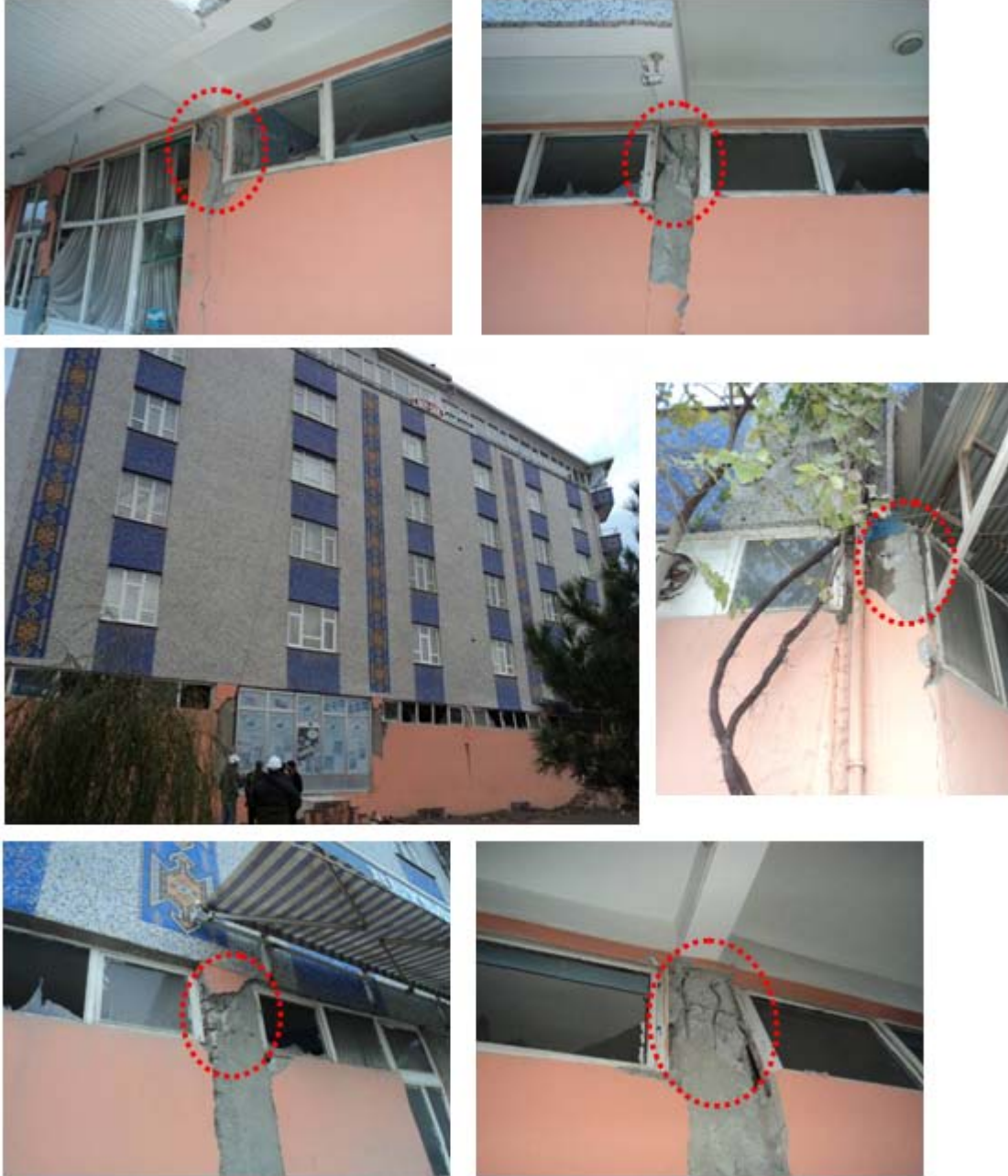
Şekil 4.26 – Tuğla duvarlarda bulunan pencere boşlukları nedeniyle kolonlarda oluşan hasar
