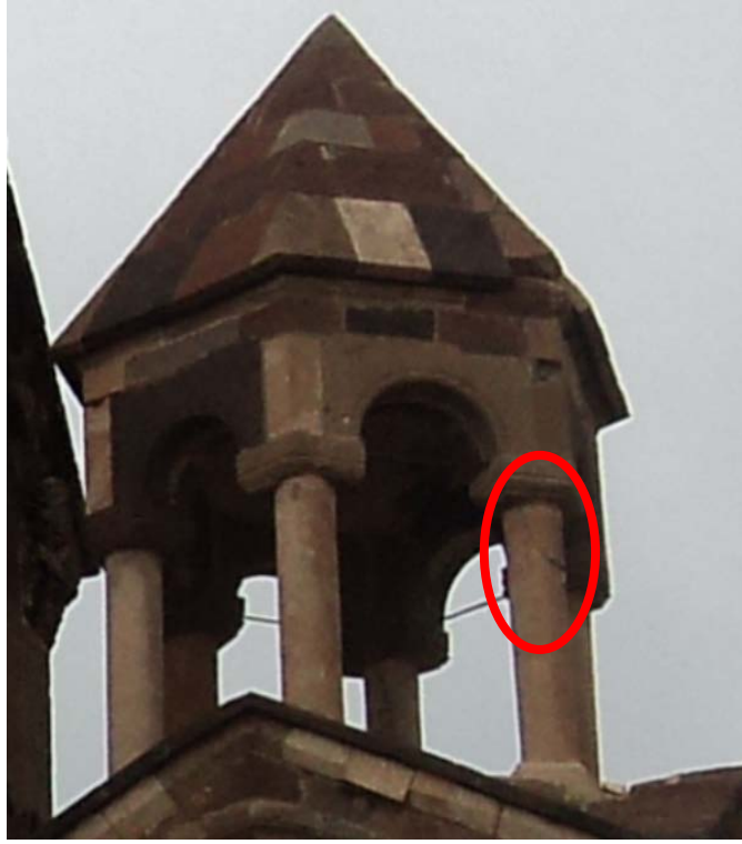
Şekil 4.88 – Akdamar Kilisesi'nin çatlayan çam kulesi kolonu görünümü
