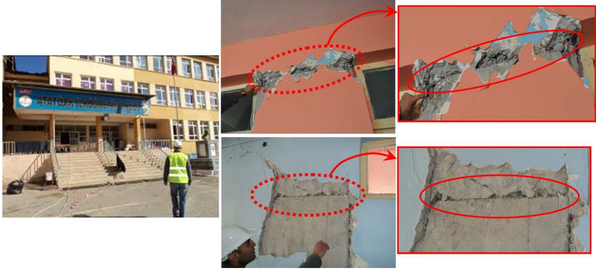
Şekil 4.3 – Atatürk İlköğretim Okulu binasında agrega ve betonun yerleştirilmesi ile ilgili sorunlar
