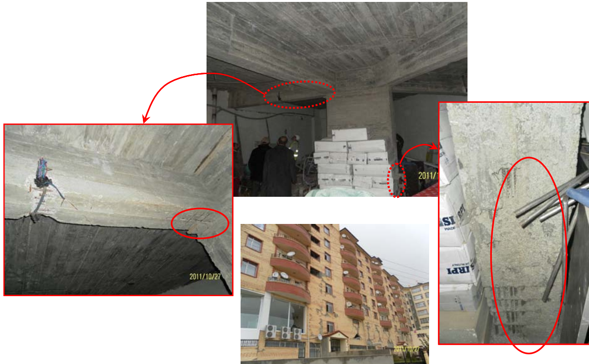
Şekil 4.5 – Kolon ve kirişlerde iyi yerleştirilememiş beton
