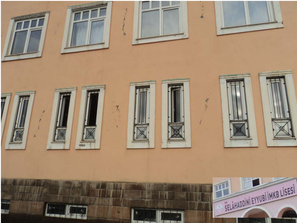
Şekil 4.43 – Van Selâhaddinî Eyyubi İMKB İlköğretim Okulu'nun duvar çatlakları
