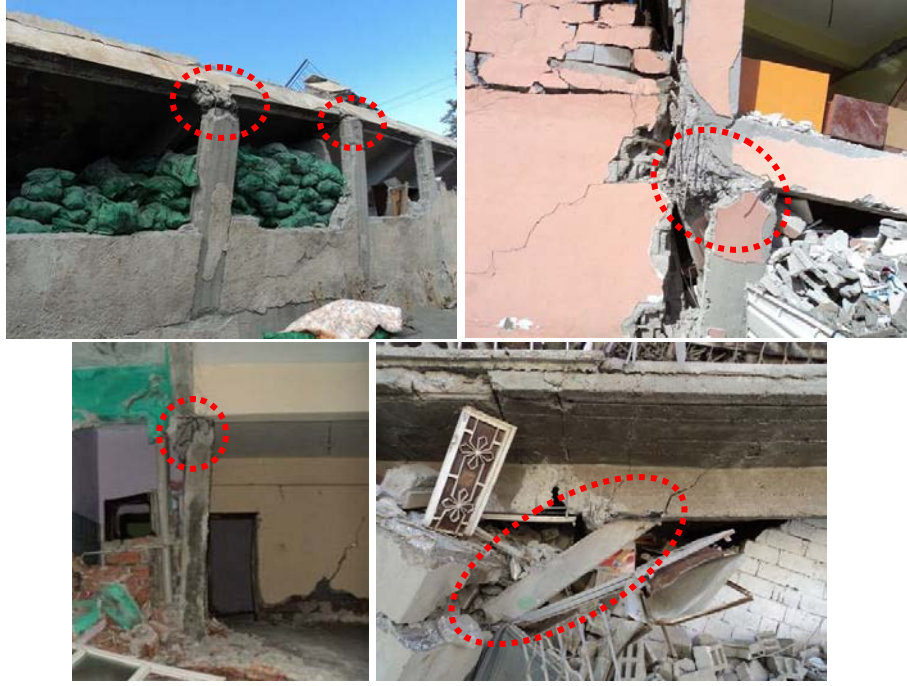
Şekil 4.21 – Kolonların krişlerden daha zayıf olmasından kaynaklanan hasarlar
