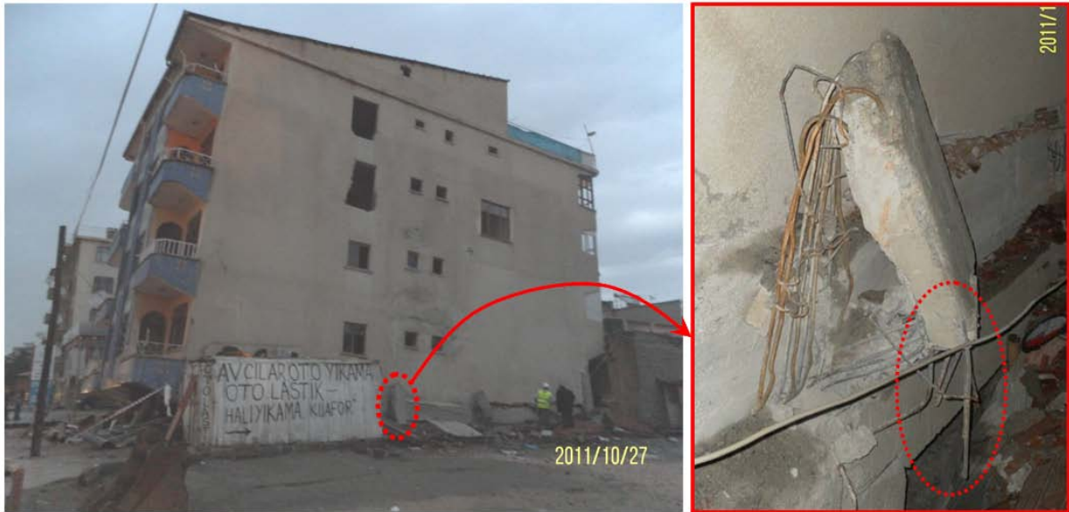
Şekil 4.11 – Zemin katta oluşan göçme ve kolon alt ucunda donatı sıyrılması
