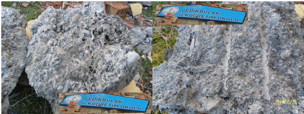
Şekil 4.75 – Gedikbulak İlköğretim Okulu'nun kullanılan betonun kalitesi
