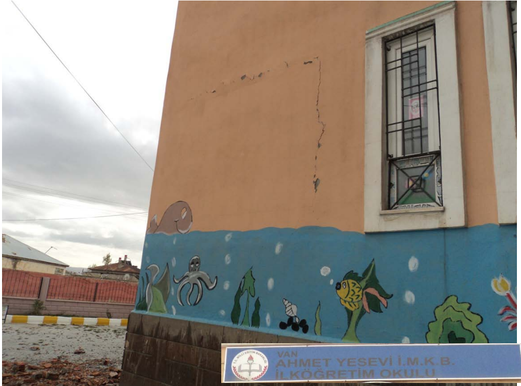
Şekil 4.44 – Van Ahmet Yesevi İMKB İlköğretim Okulu'nun duvar çatlakları
