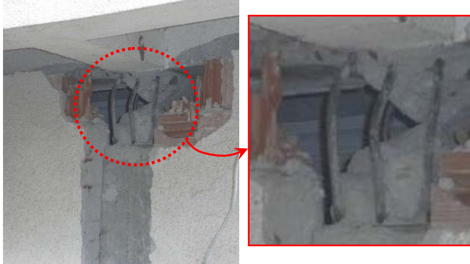
Şekil 4.18 – Etriye seyrekliği nedeniyle kolon donatılarının burkulması
