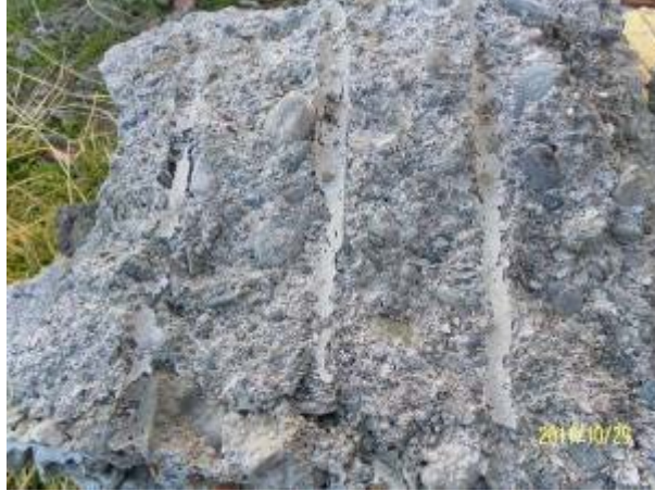
Şekil 4.9 – Düşük beton kalitesi nedeniyle donatı ile beton arasında yetersiz aderans oluşması
