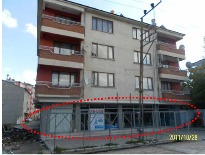
Şekil 4.23 – Zemin katta tuğla duvar bulunmaması nedeniyle ortaya çıkan rijitlik değişimi
